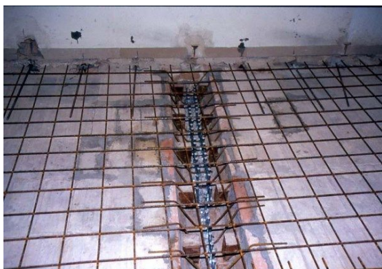
Solaio a doppia orditura con connettori tipo Tecnaria solo sulle travi principali, i connettori ai quarti estremi della luce sono disposti su due file; da notare le barre di ancoraggio a muro.
