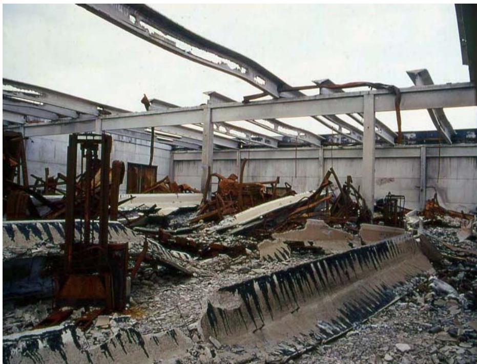
Foto 5.3: Capannone di cemento armato completamente distrutto a seguito di un incendio.
