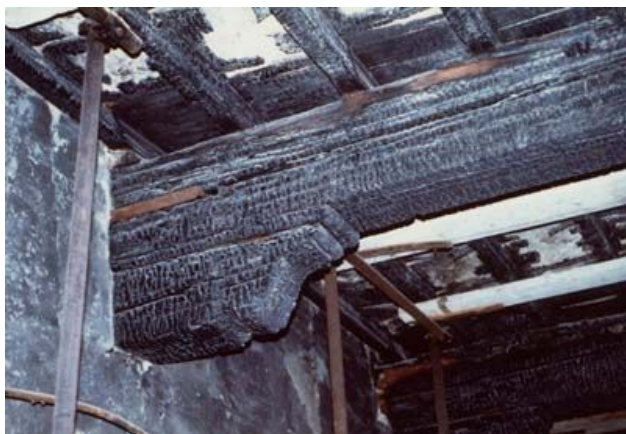
Foto 5.1: Solaio di legno non crollato a seguito di un incendio.
