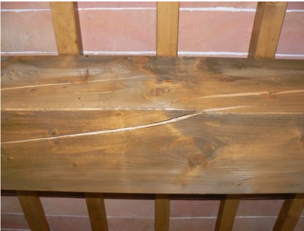
Foto 1.1: Le fessure da ritiro sono un fatto fisiologico che generalmente non deve destare preoccupazione, tuttavia in alcuni casi diventano strutturalmente intollerabili, ad esempio quando una trave è affetta da fessure su due facce e queste si incontrano dividendo in due la sezione oppure quando queste passano lo spigolo determinando una vera e propria rottura come nella foto.
