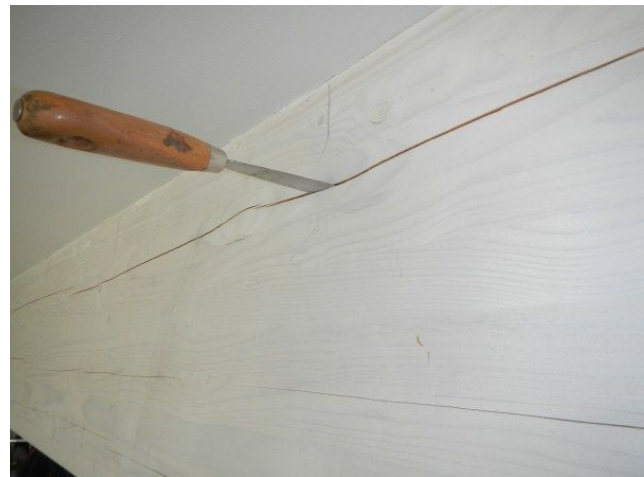
Foto 3.3: Fessura da ritiro in una trave di legno lamellare. La pittura bianca rende più evidenti le fessure, strette come ampiezza ma di profondità apprezzabile.
