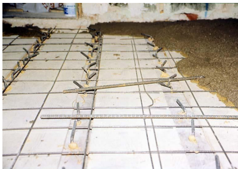
Solaio a singola orditura con connettori del tipo "Turrini-Piazza" (barre di acciaio da c.a. fissate nel legno con malta epossidica)
