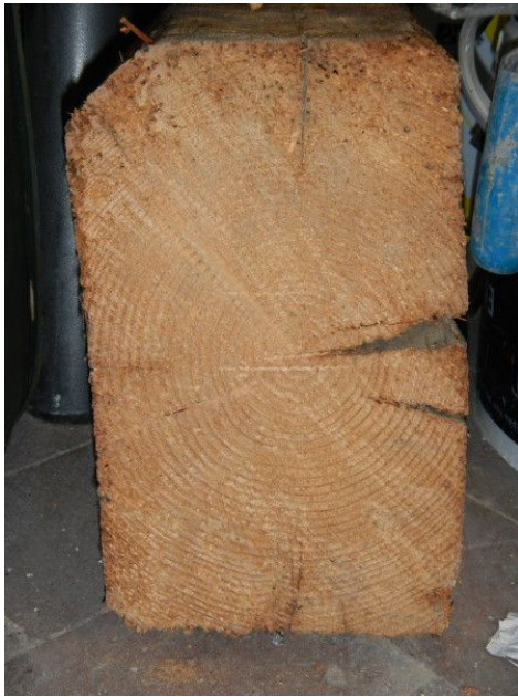
Foto 3.2: Fessura da ritiro principale (ampia) e fessure da ritiro secondarie in una trave di abete massiccio.
