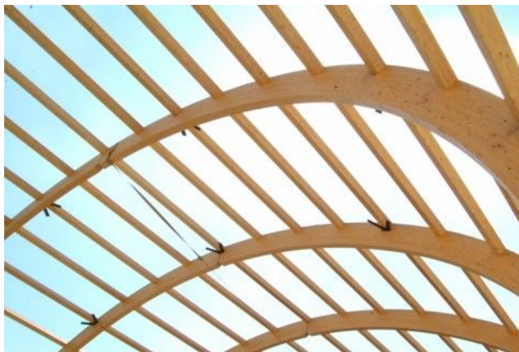
Foto 3.1: Archi a tre cerniere di legno lamellare a copertura di una palestra.
