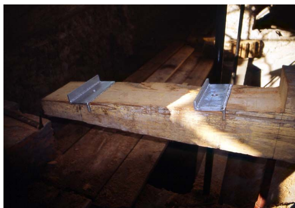
Vista della catena già conformata
