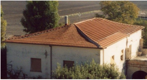
Deformazioni di una copertura in legno.
