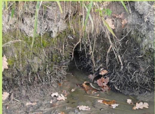
La tana di una nutria scavata nell'argine di una zona umida.
