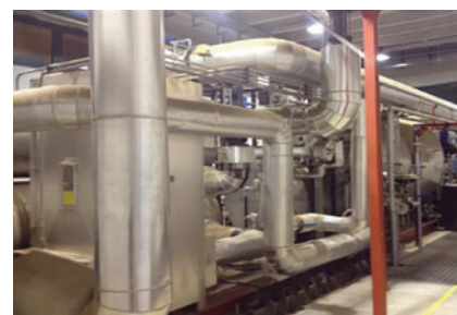
FIGURA 7. La turbina ORC da 1 MW
