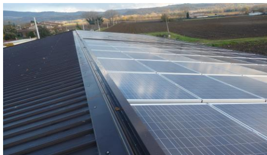
2014 - Impianto Fotovoltaico 135 kWp
