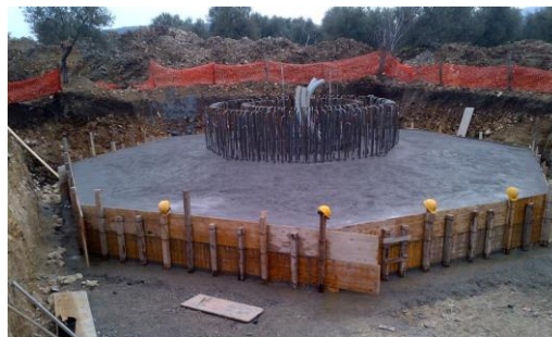
2014 - Impianto Eolico Deliceto (FG)
