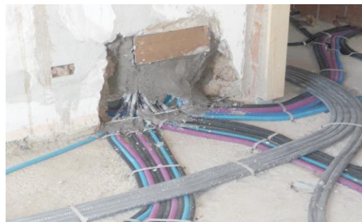
2014 - Impianto elettrico supermercato
